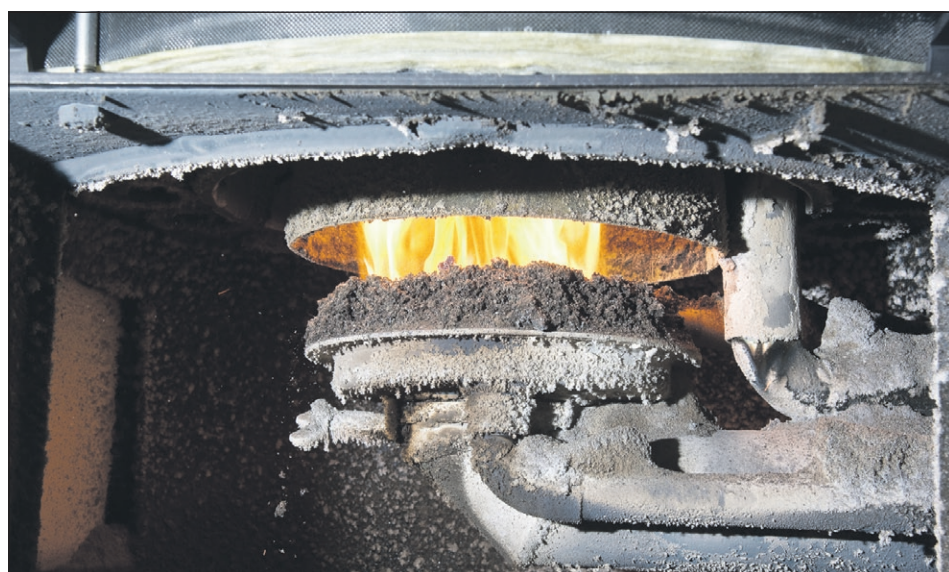
Brænderen er af "mulvarp"-typen. Stokersneglen presser træpillerne op i midten ligesom et mulvarpeskud. Deraf navnet.
